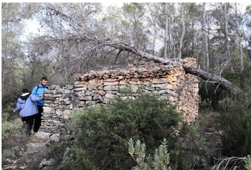
Figura 5. Caseta abandonada con pino caído encima.
